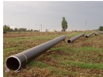
Plynovod. Zdroj: www.infoenergie.cz
